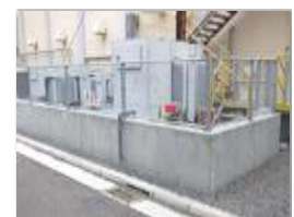
【電気設備の防潮堤】
