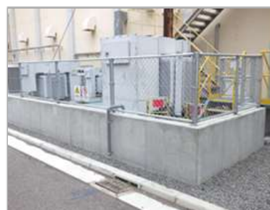
【電気設備の防潮堤】
