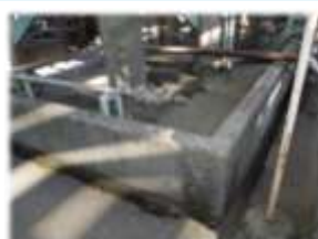
【川崎工場 防液堤の様子】
