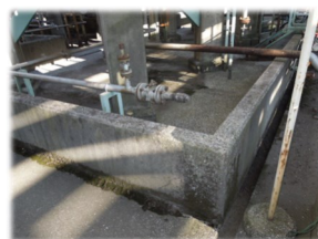
【川崎工場 防液堤の様子】
