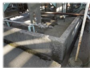
【川崎工場 防液堤の様子】
