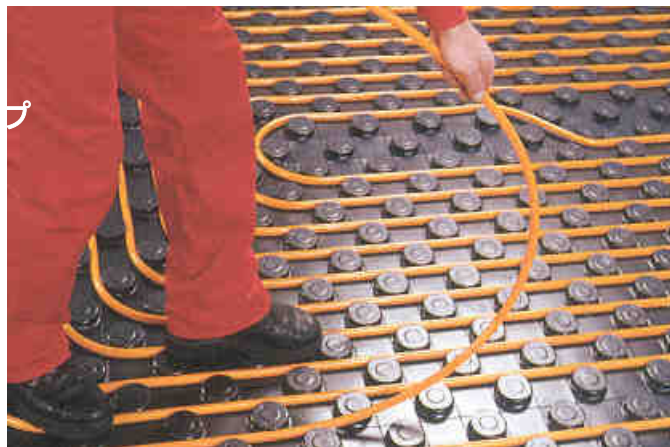
写真3 床暖房向けパイプ
